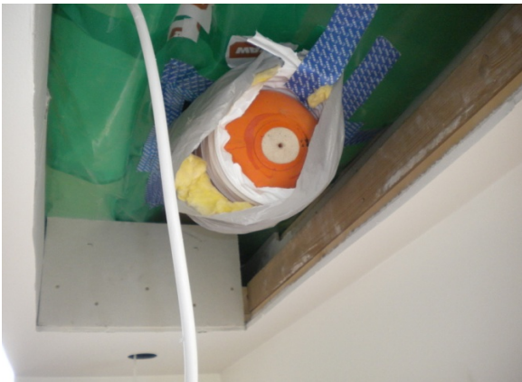
Emhætte aftræk dækket med ballon
