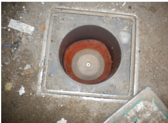
Afløb dækket med ballon
