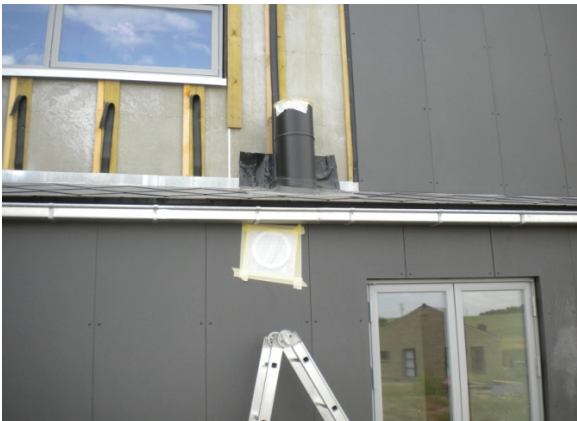
Ventilationskanal dækket med plastfolie
