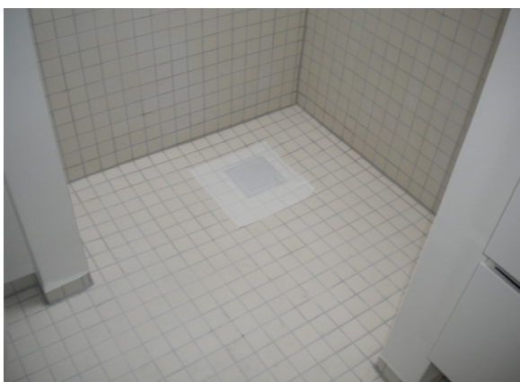
Afløb dækket med plastfolie
